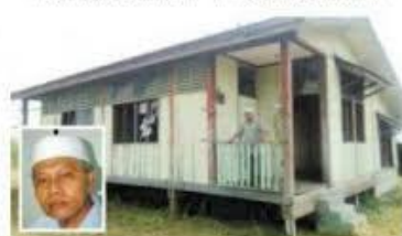
Abu Bakar meninjau keadaan infrastruktur salah sebuah rumah kuarters kerajaan di Kuala Bagan Tiang, Parit Buntar yang terjejas dan tidak diselenggarakan dengan baik. Gambar kecil: Abu Bakar.
